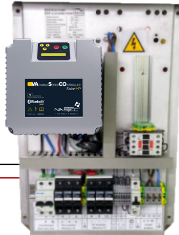
Variador trifásico 20HP / 380VAC
